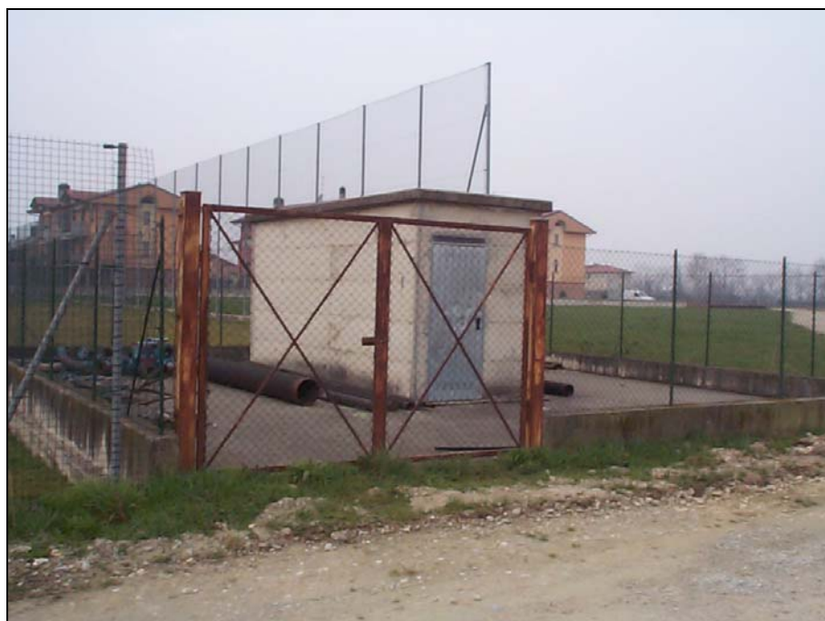
Foto n. 8 – Pozzo comunale n. 1b
